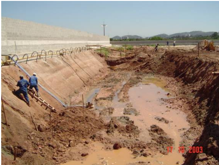
Escavação e rebaixamento do NA com ponteiros (crista do talude) e bomba submersa (fundo da escavação).
